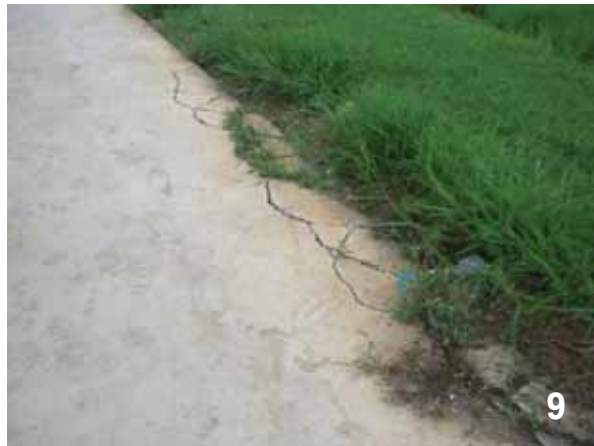
Figura 17 – Pavimentação danificada. Fonte: MANO, L. (2012)
