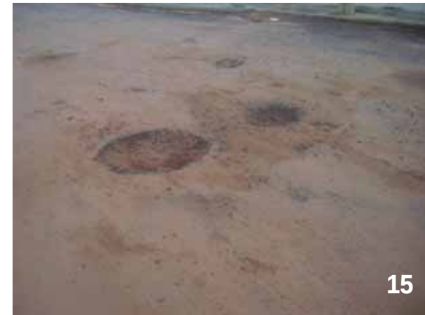
Figura 23 – Buracos na via pública.
