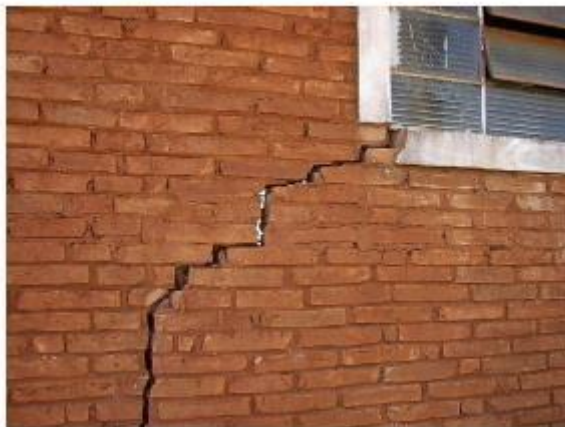
Figura 2 – Danos causados a edificações devido a presença de solo colapsível.
