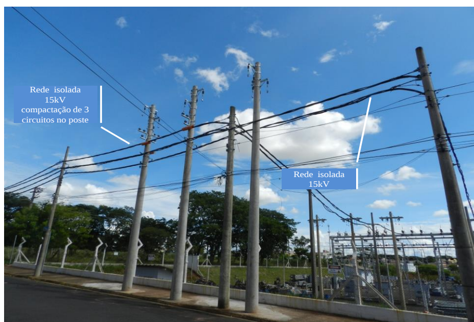
Figura 21 – Rede isolada de 15kV com 3 circuitos na mesma posteação
