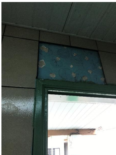
Figura 10: Azulejo faltando no banheiro masculino.
