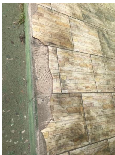
Figura 3: Imagem de piso quebrado, há também alguns que apresentam manchas com uma suposta infiltração.
