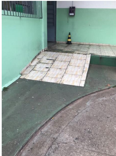
Figura 5: Imagem rampa de acesso sem equipamentos de segurança (corrimão, adesivos antiderrapantes)
