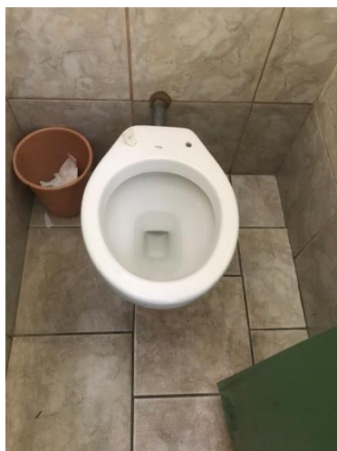
Figura 13: Banheiro sem assento sanitário.
