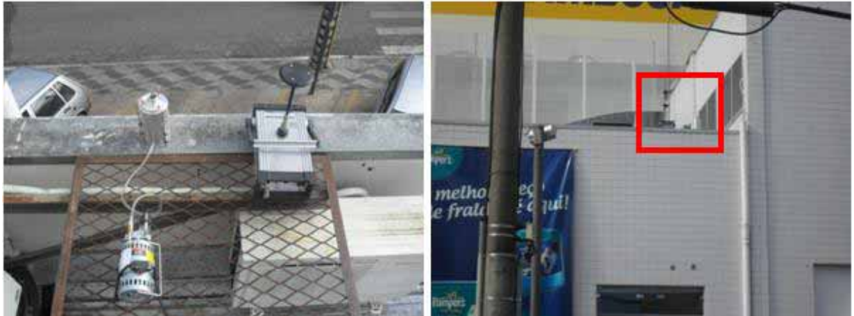
Figura 20. Equipamentos alocados em um telhado comercial no centro de Itapeva-SP.
