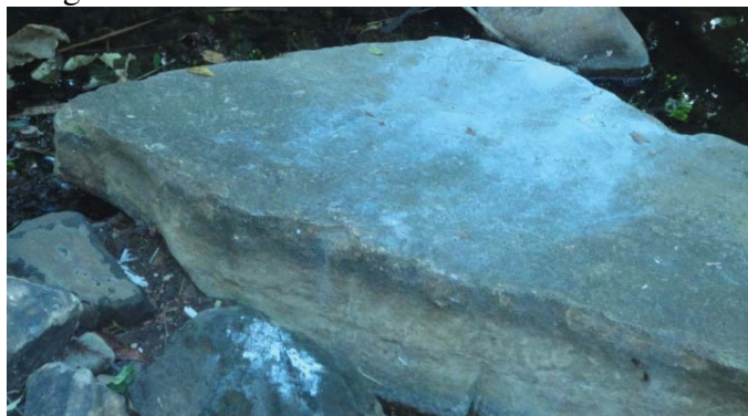
Figura 48 – Mancha de sabão em bloco de arenito
