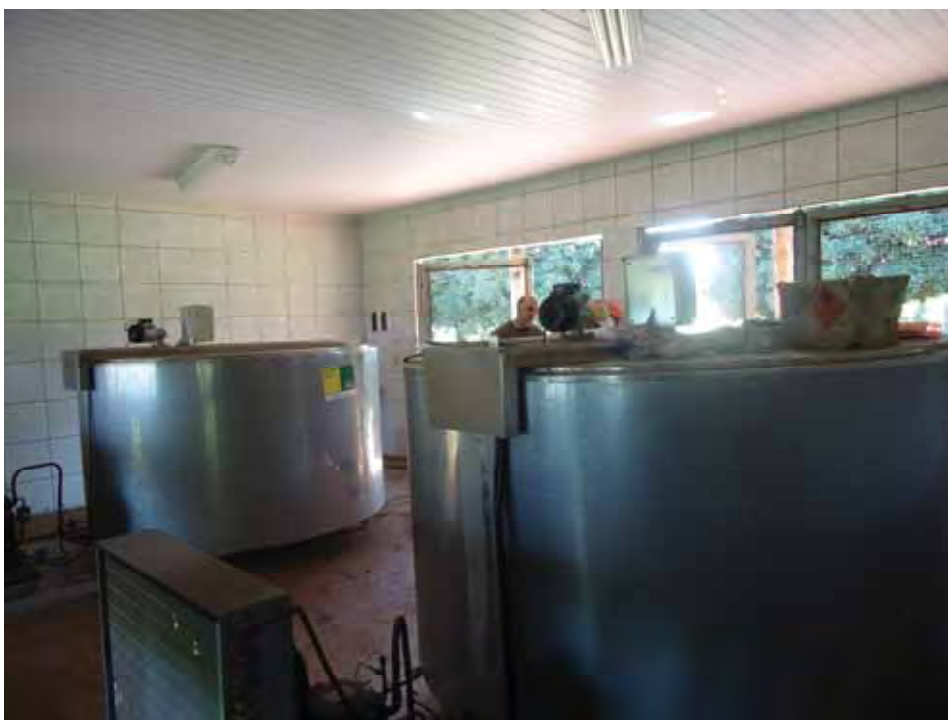
Figura 14. Tanques de resfriamento no Assentamento Santa Maria da Lagoa, Município de Ilha Solteira.
