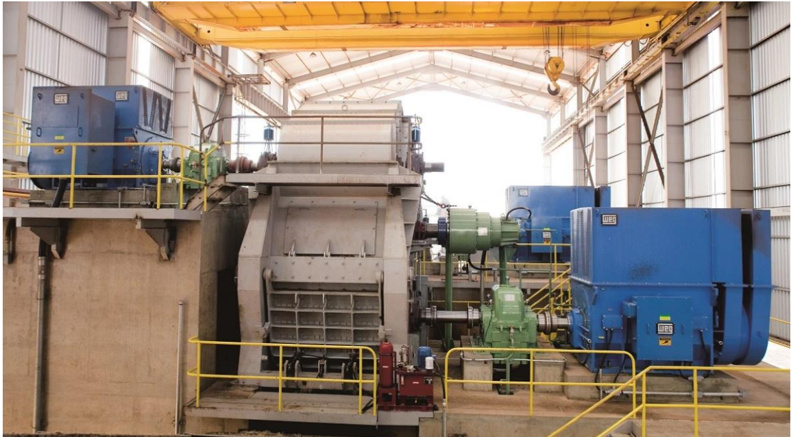
Figura 29 – Motores de indução trifásicos empregados no processo de preparo
