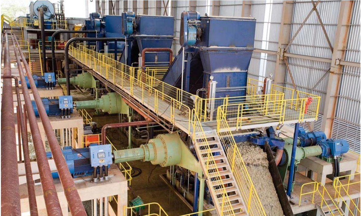
Figura 30 – Motores de indução trifásicos empregados no processo de extração
