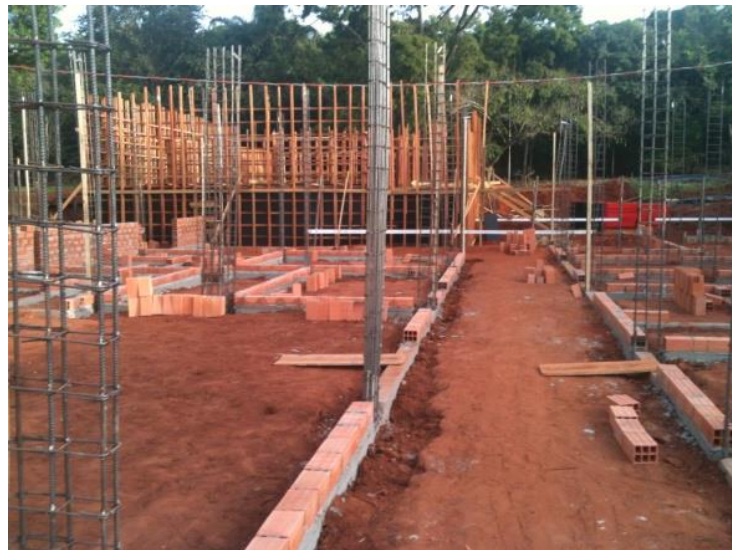
Figura 1: Fundação e estrutura da clínica. Início da etapa de alvenaria (Foto tirada em 21/05/2014 - Hospital Unimed Bauru).
