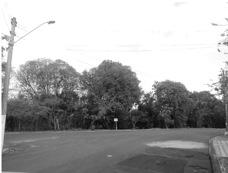
Figura 16: Falta de microdrenagem localizada na Av. Marginal Bonsucesso.
