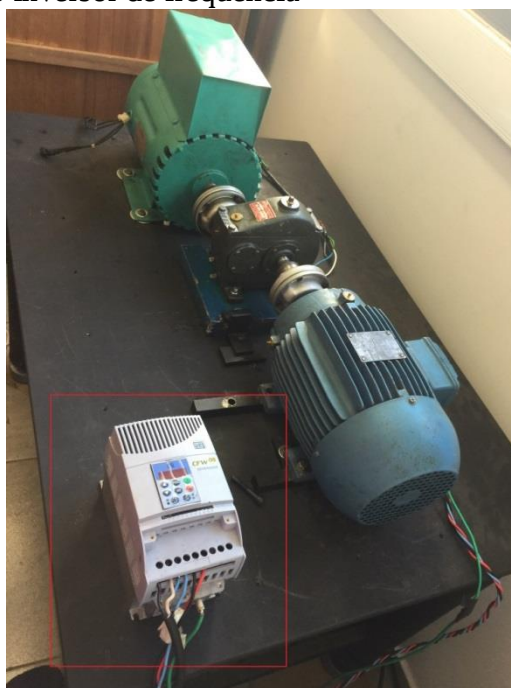
Figura 15 - Em destaque o inversor de frequência
