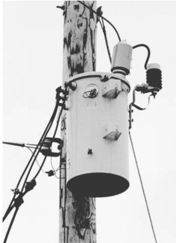
Figura 2 – Transformador a óleo de poste.
