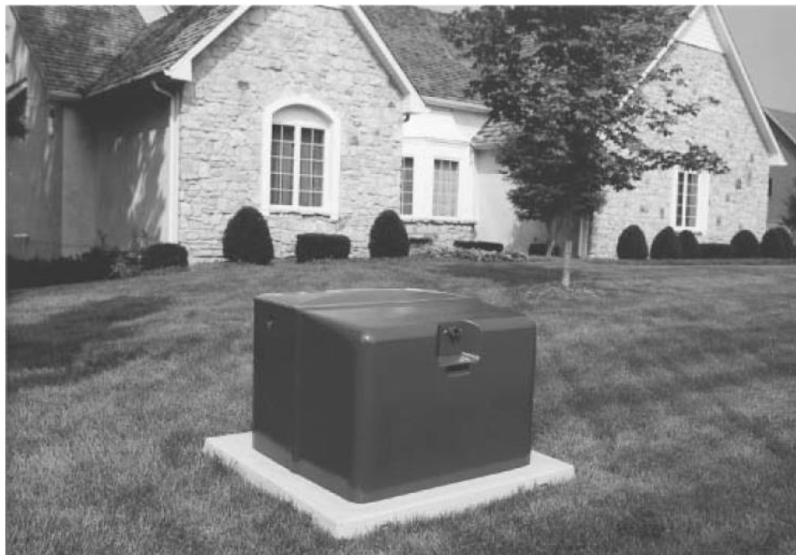
Figura 1 – Transformador a óleo padmount .
