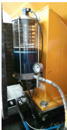
Figura 70 – Reservatório de graxa para sistema de lubrificação automática.
