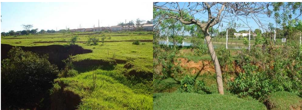
Figura 177: Da esquerda pra direita, braços de voçorocamentos em direção a bairros próximos e erosão as margens da ETE de Tarabaí. Autor: Éder Pereira dos Santos, 2012.
