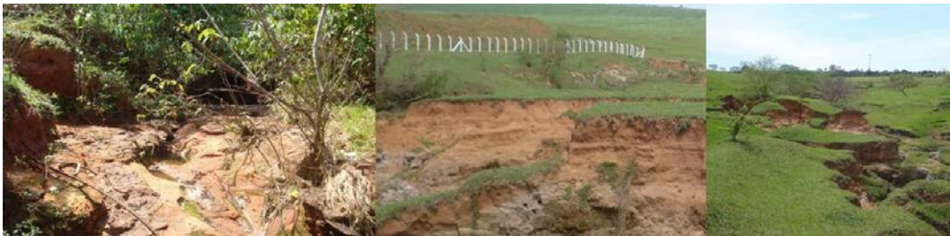
Figura 178: Da esquerda pra direita, galeria pluvial e ponto de lançamento e processo erosivo evoluindo a condição de voçorocamento. Autor: Éder Pereira dos Santos, 2012.
