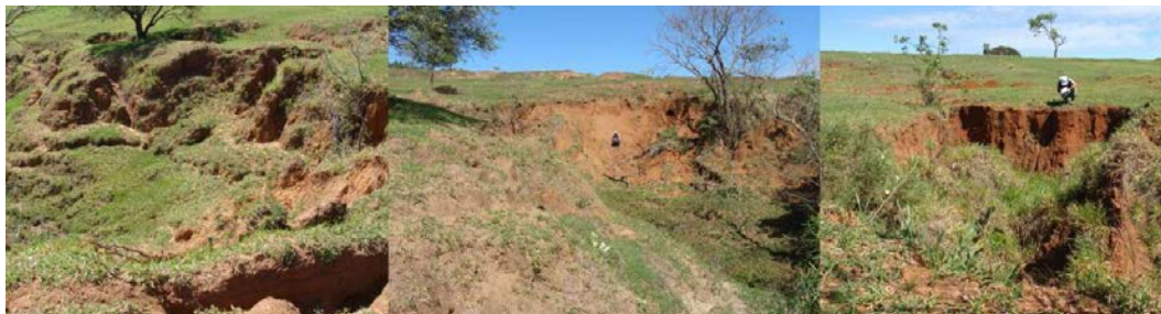
Figura 188: Processos erosivos em estágio de voçorocamento em área da antiga Fazenda Rebojo.
