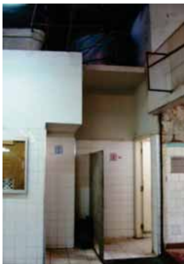
Figura 53 - Situação precária dos sanitários e a caixa d'água a vista (Fonte: Autor, 2010).
