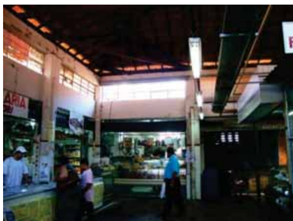
Figura 47 - Interior do mercado em mal estado de conservação (Fonte: Autor, 2010).
