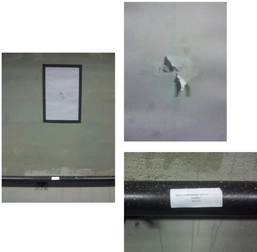
Figura 29: Registro de intervenção na obra. À esquerda, registro aberto do quadro e corrimão com adesivo. À direita, detalhe do quadro e do adesivo no corrimão. Autoria: desconhecida. Foto: Vitória Teivelis, 2017.
