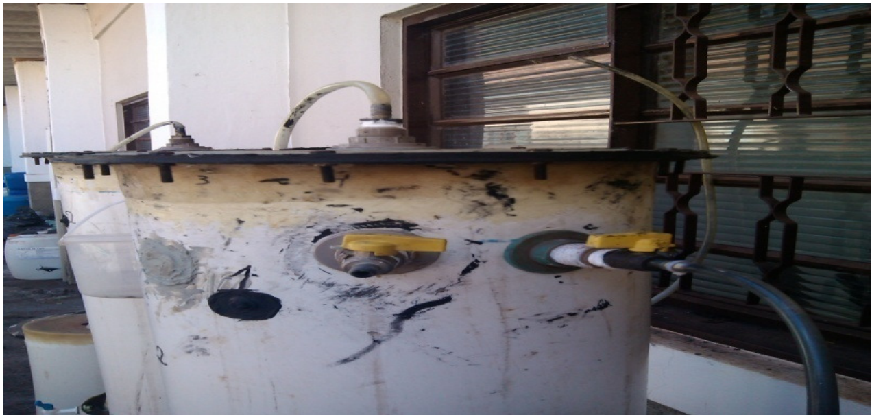
Figura 4. Vista da parede lateral superior do reator batelada com o registro de nível do líquido e o registro usado para carga do sistema. Fonte: o autor
