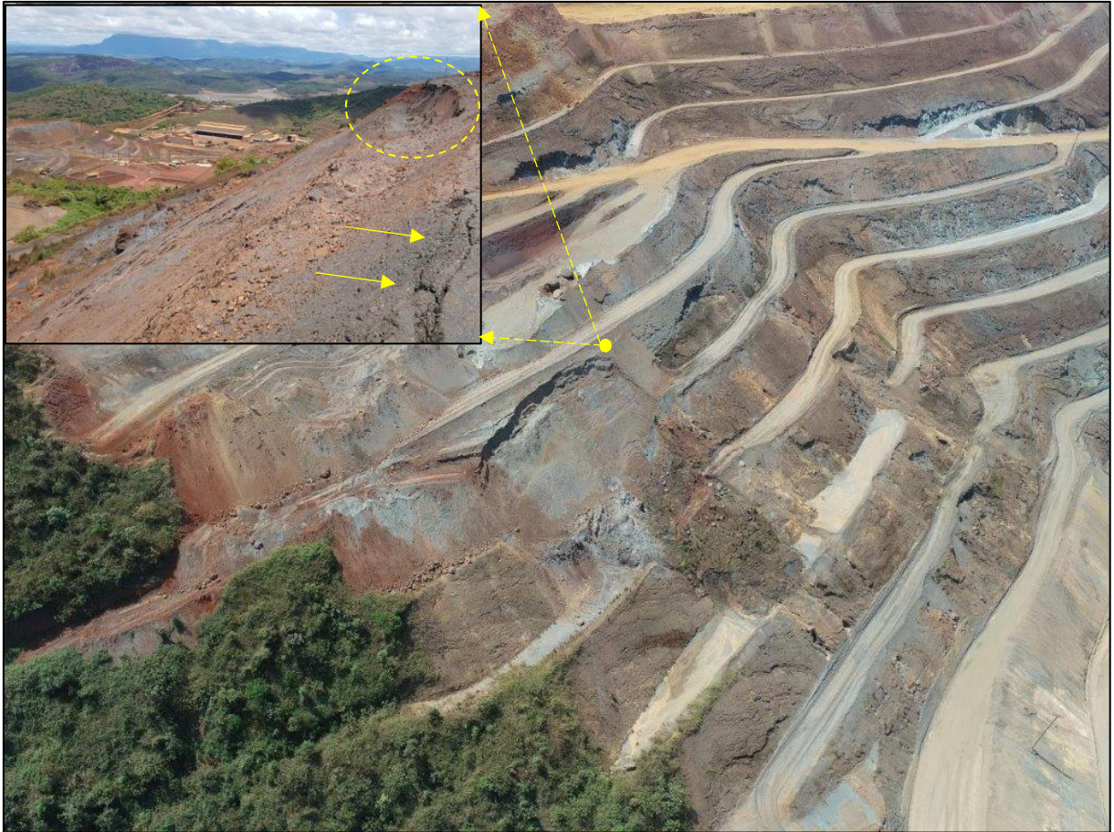
Figura 44. Condições dos taludes em setembro/2020, com destaque para a ruptura plano-circular e trincas no topo da berma.
