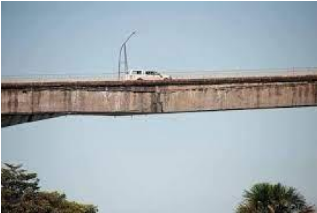
Figura 25 - Imagem com rachadura, mas muito distante.
