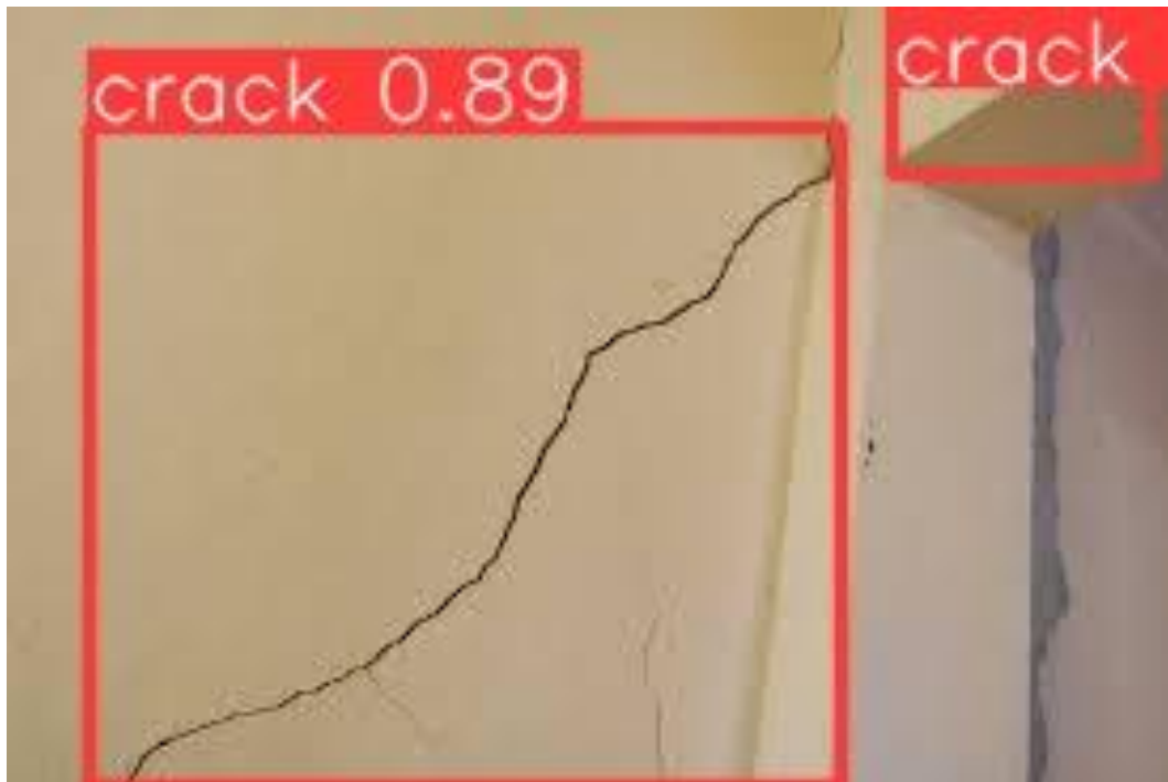
Figura 24 - Imagem com rachadura e um canto inclinado.
