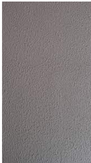
Figura 23 - Imagem sem nenhuma rachadura.
