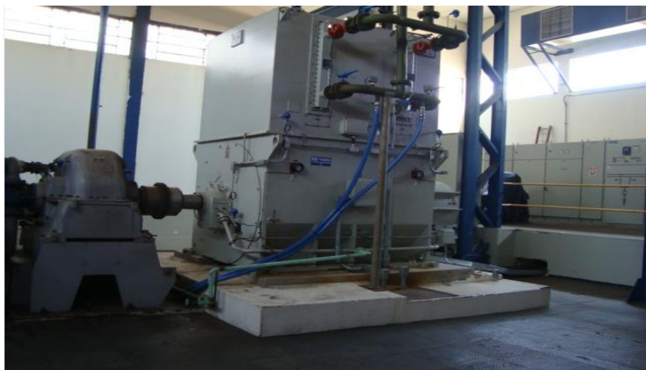
Figura A.1.1 - Turbina e Gerador (Planta I)
