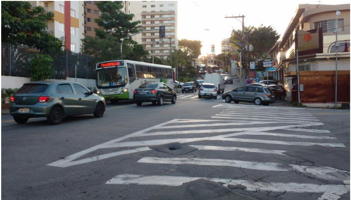
Figura 14: condição precária da via Asfalto "remendado", rachado e esburacado - Estrada do São Francisco – Taboão da Serra
