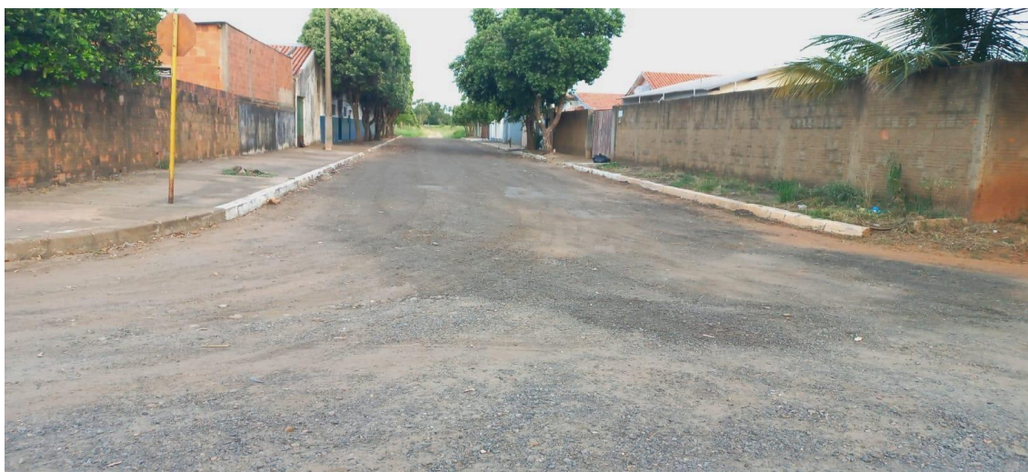
Figura 3. Vias sem sistema de microdrenagem
