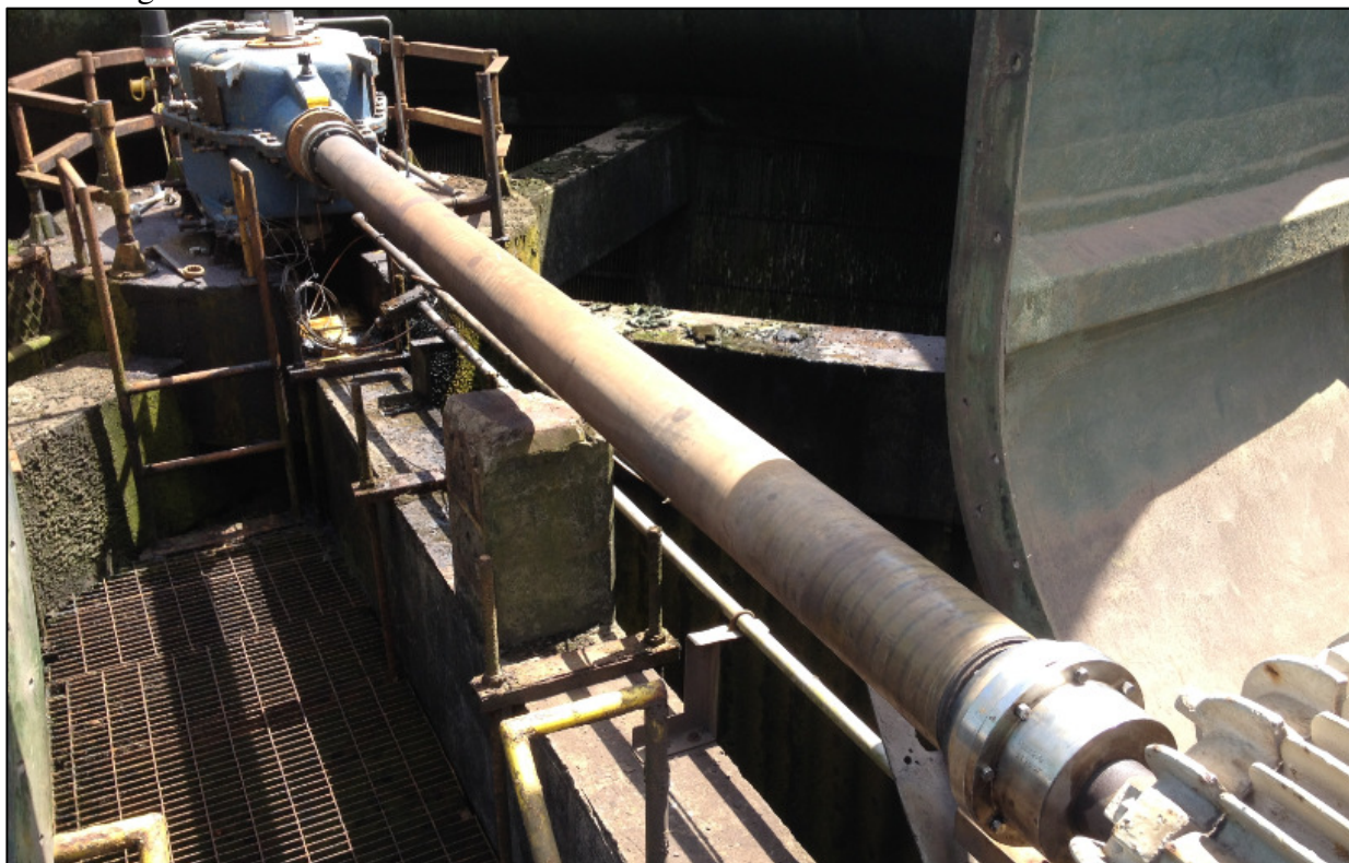
Figura 17: Eixo flutuante de torre de resfriamento em fibra de carbono – Gerdau.
