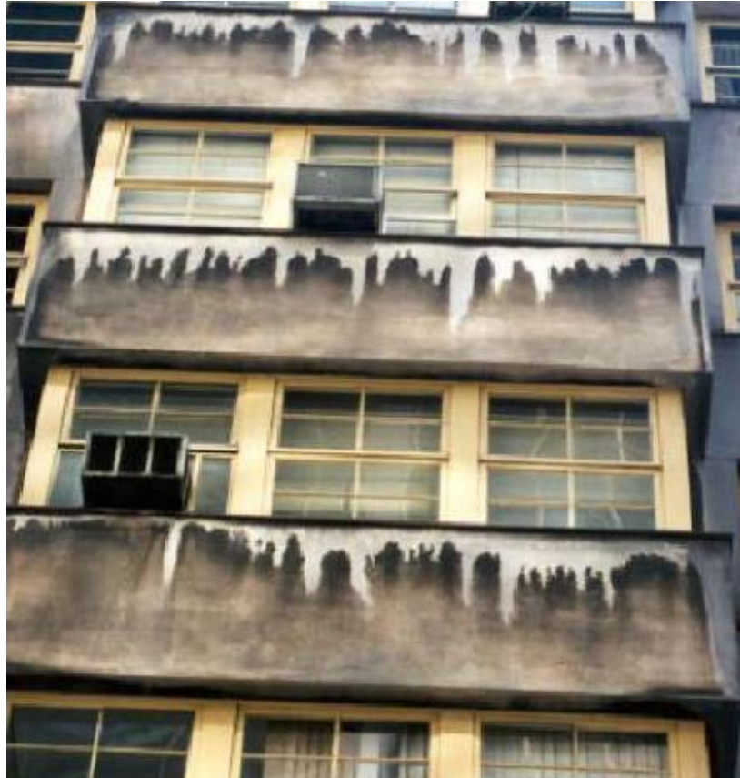
Figura 10 – Manchas de sujeira em parapeitos por escoamento de chuva
