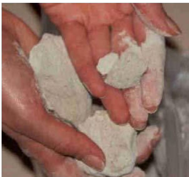
Figura 12 – Descolamento com empolamento
