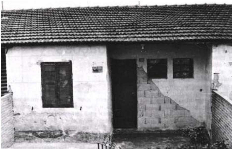
Figura 13 – Descolamento em placas
