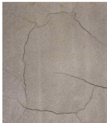
Figura 8 – Revestimento apresentado fissura em configuração de mapa
