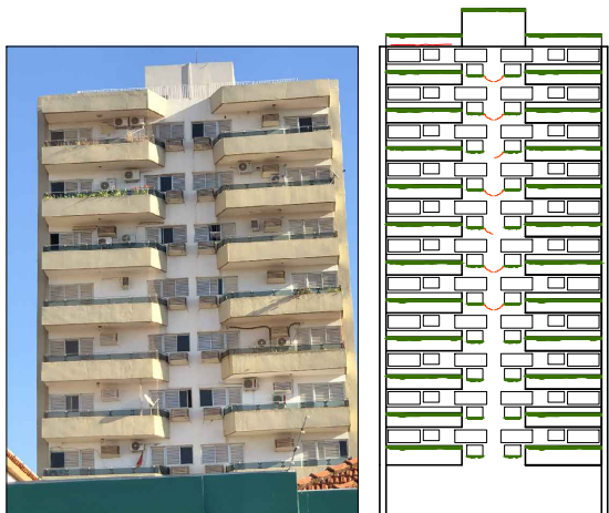
MAPEAMENTO FACHADA NORTE
