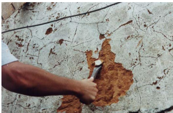
Figura 14 – Descolamento com pulverulência em argamassa de saibro
