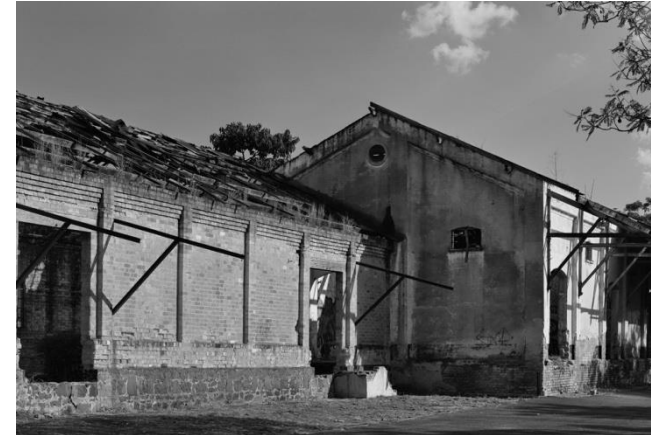
Figura 91: O prédio da estação deteriorado.
