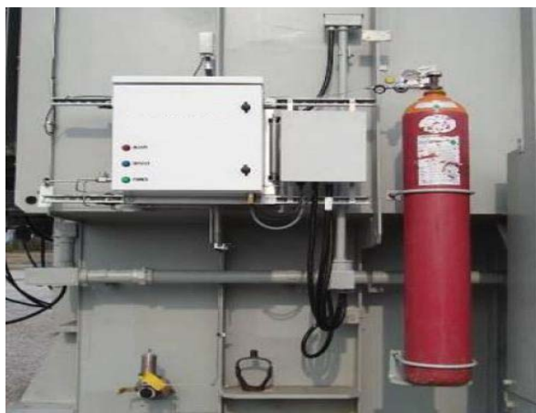
Figura 4.3 – Sensor 1 instalado junto ao corpo do transformador
