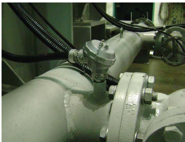
Figura 4.15 – Sensor de temperatura de óleo instalado no transformador
