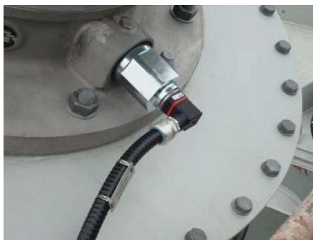
Figura 4.9 – Sensor de fuga de corrente na bucha instalado na base da bucha do transformador
