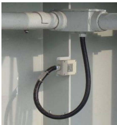
Figura 4.13 – Sensor de temperatura ambiente instalado no transformador
