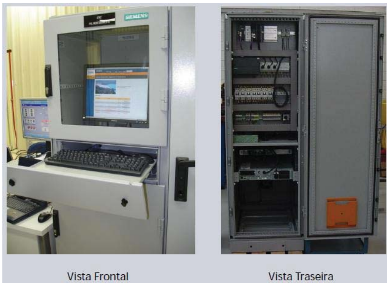
Figura 4.26 – Painel Central instalado na casa de comando e controle da subestação
