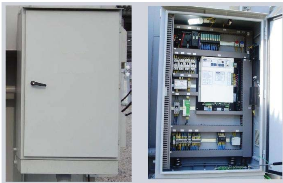
Figura 4.25 – Foto do Painei Local instalado no corpo do transformador
