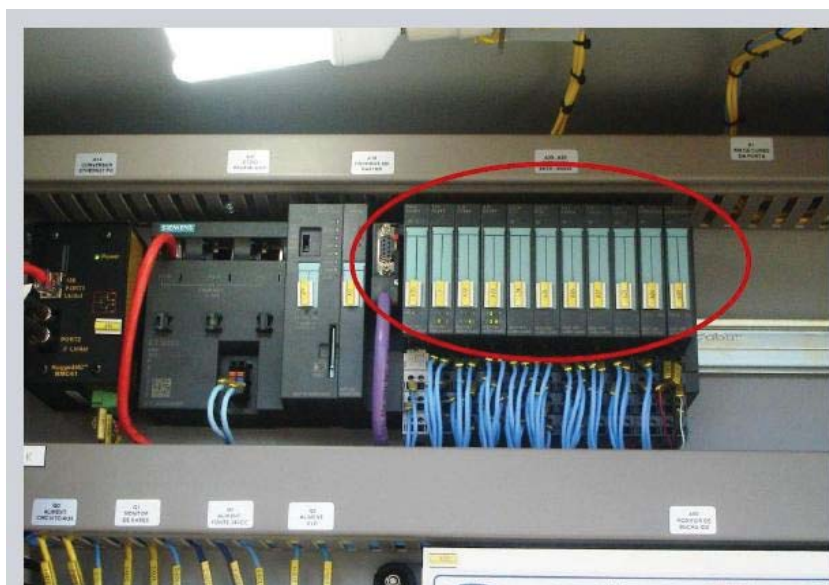
Figura 4.23 – Módulos de comunicação instalados
