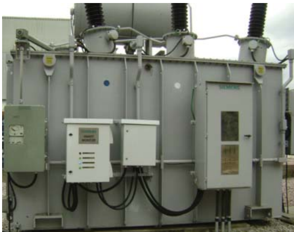
Figura 3.5 – Sistema de monitoramento distribuído instalado em transformador de potência (SIEMENS, 2012)
