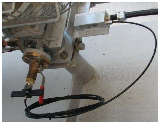
Figura 4.6 – Sensor de umidade instalado no corpo do transformador
