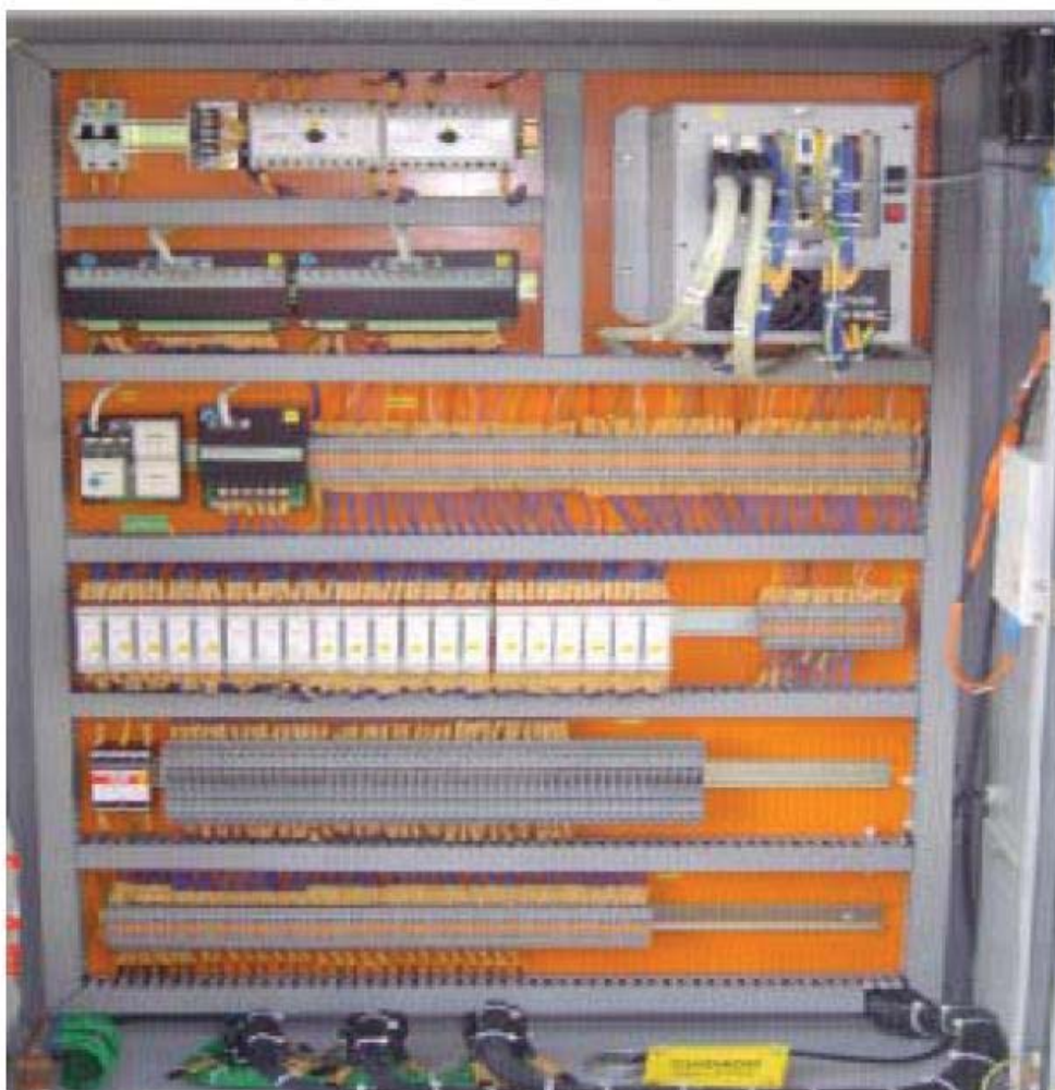
Figura 3.2 – Protótipo de um sistema de monitoramento instalado em uma subestação de transmissão (SILVA; JARDINI; MAGRINI, 2005)
