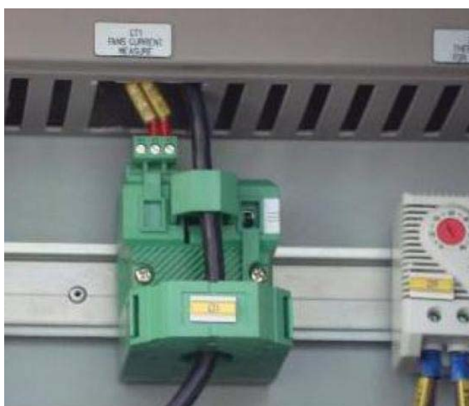
Figura 4.21 – Sensor de corrente instalado no transformador
