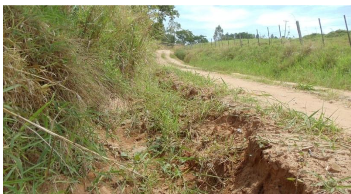
Figura 31: Erosão na lateral da estrada causada pelo escoamento superficial.
