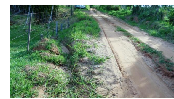
Figura 33: Caminho que o escoamento superficial percorre para o lado esquerdo da estrada.
