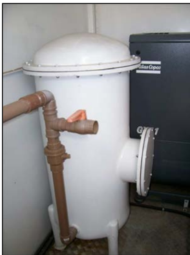
Foto 1- Detalhes internos do sistema de bombeamento – coluna de carvão ativado
