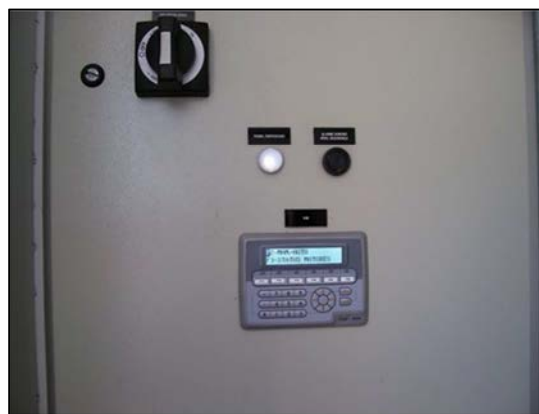
Foto 3 -Painel de controle com CLP do sistema de bombeamento
