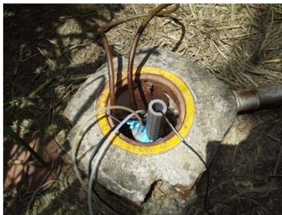
Foto 12- Poço de extração PM-28, com o cabeçote de DPE e transmissores de pressão e nível instalados.
