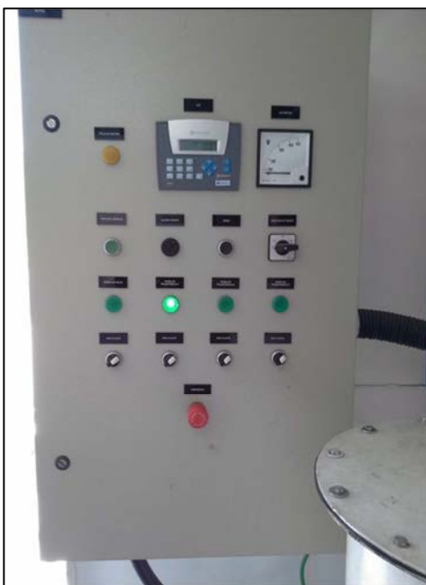
Foto 5- Detalhes do painel de controle do sistema TPE
