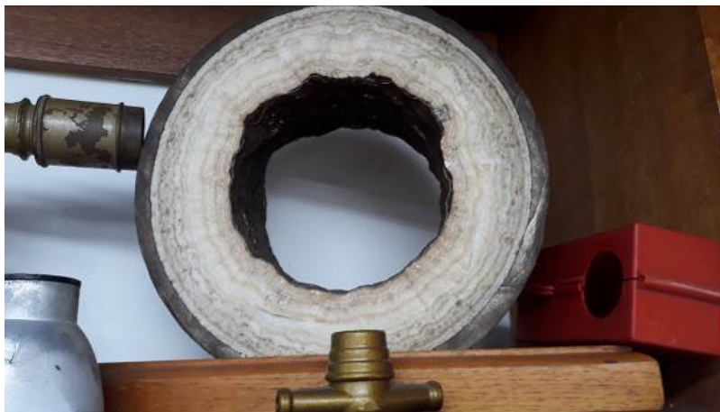
Figura 4-28 Incrustações de carbonato
