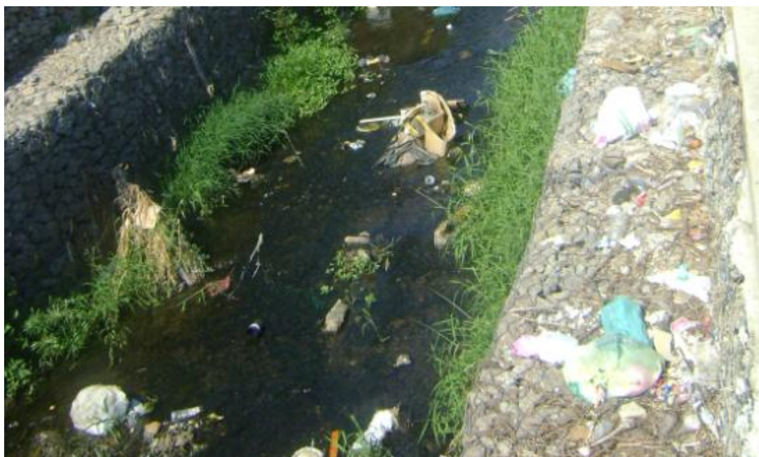
Figura 27 - Córrego no parque linear Sapé.
