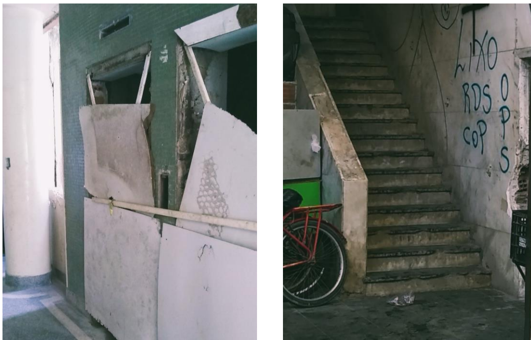
Figura 53: Condições de inadequação construtiva.
