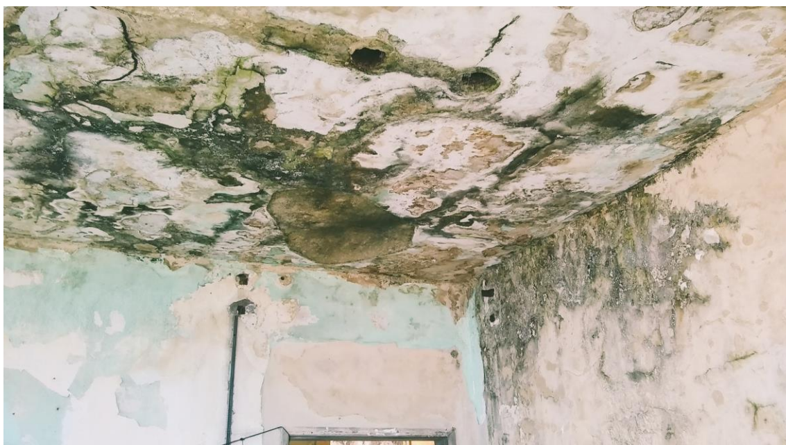
pontos de grave infiltração nos pavimentos superiores
