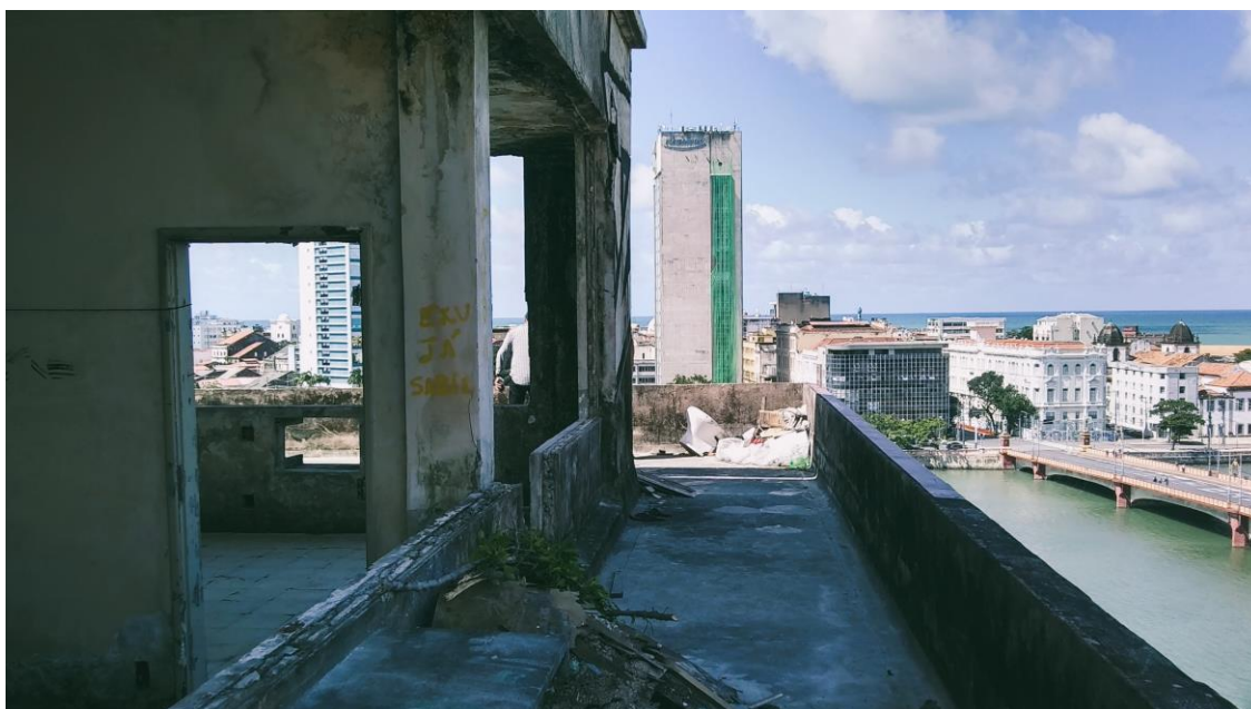
ausência de guarda-corpo ou obstáculos contra quedas
