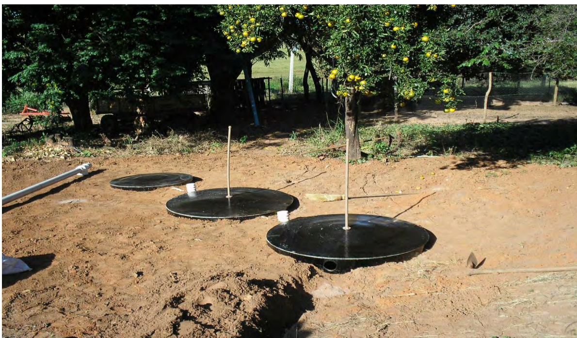
Figura 34 – Fossa séptica biodigestora instalada na microbacia do Ribeirão Lagoa, município de Jales. Fonte: EDR de Jales.
