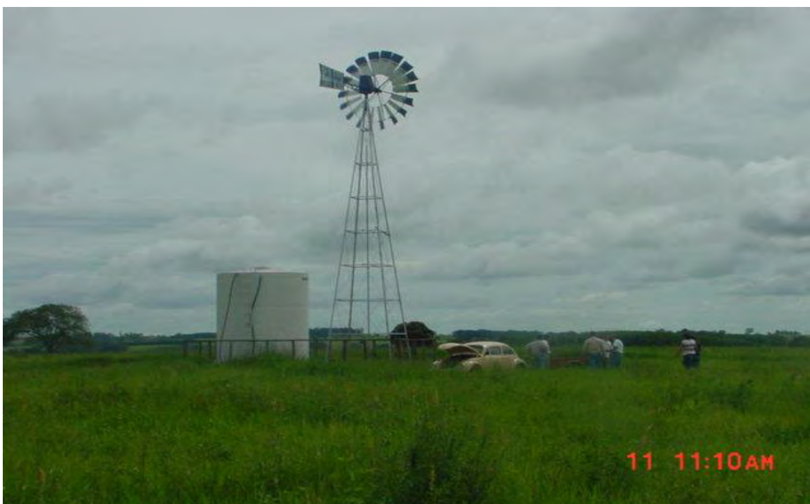
Figura 20 – Poço semiartesiano movido a energia eólica, construído no município de Santa Fé do Sul pelo programa de microbacias. Fonte: Escritório de Desenvolvimento Rural (EDR) de Jales.
