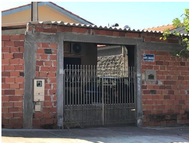
Figura 89 – Residência do CHJDN alterada com perda de iluminação e ventilação natural da sala e de um dos dormitórios
