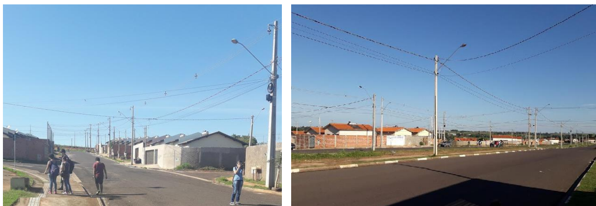
Figura 70 – Postes e fiação componentes do sistema de energia elétrica do CHJDN
