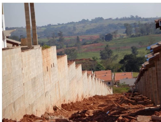
Figura 58 – Via com declividade acentuada no CHJDN
