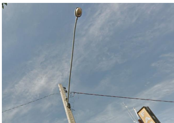
Figura 23 – Luminária fechada localizada na Avenida Raymundo Nonato Lima no CHAJ
