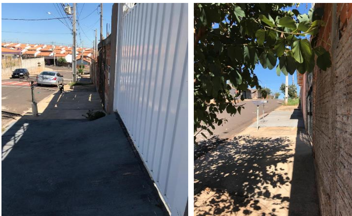
Figura 69 – Calçadas no CHJDN onde a área permeável entregue originalmente, foi pavimentada
