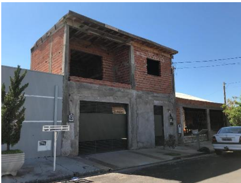
Figura 90 – Ampliação de residência no CHJDN que descumpre as dimensões de recuos estabelecidas pela legislação municipal
