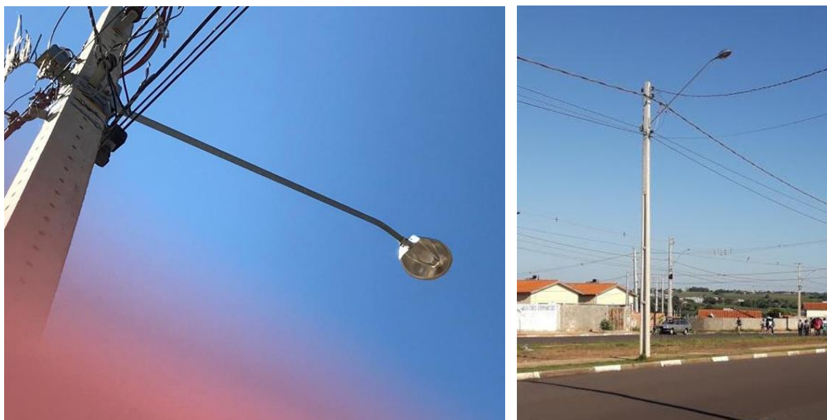
Figura 71 – Lâmpada e luminária de uma via pública do CHJDN
