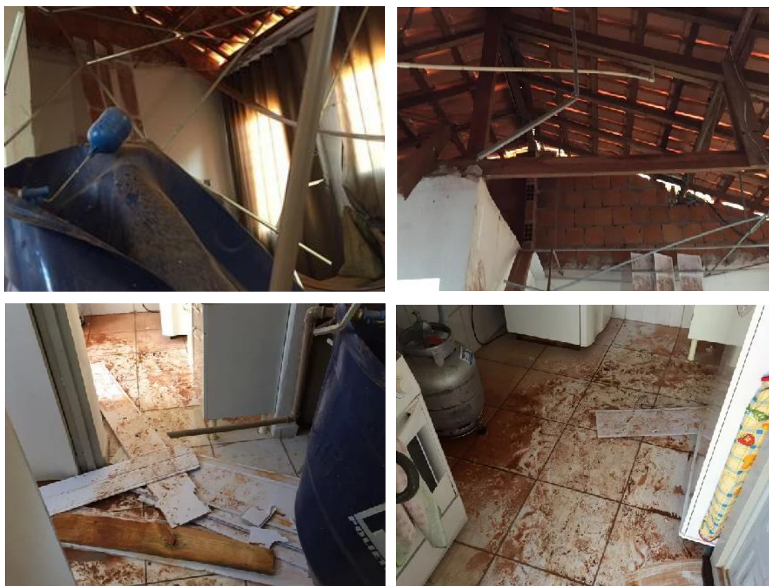
Figura 97 – Danos provocados pela queda da caixa d'água em residência do CHJDN
