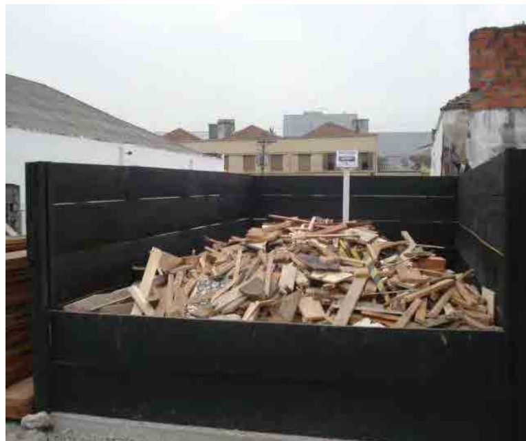
Figura 60 – Baias para segregação dos resíduos de madeira.
