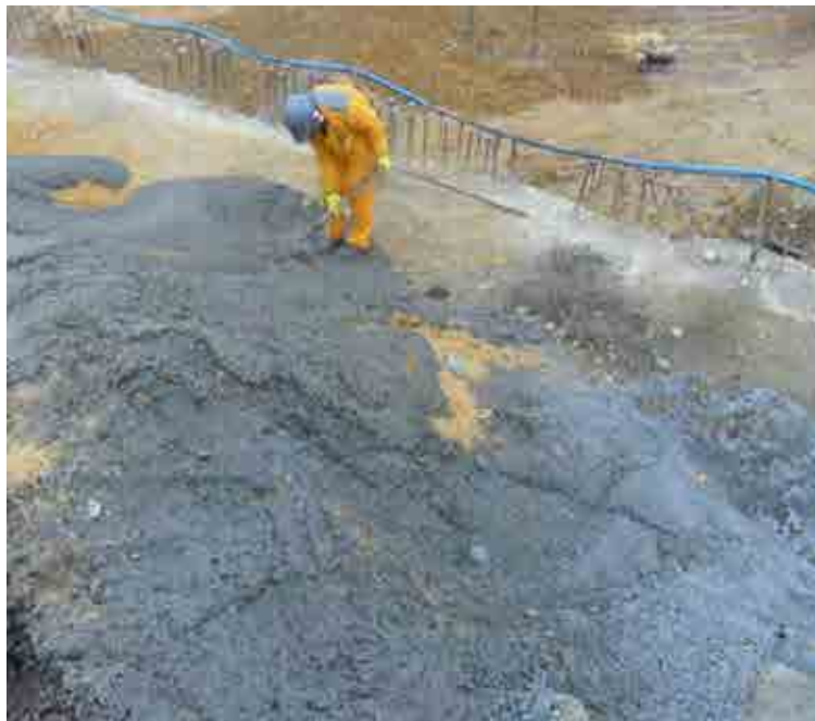
Figura 36 – Utilização da sobra do concreto para viabilização dos acessos dentro do canteiro de obras.
