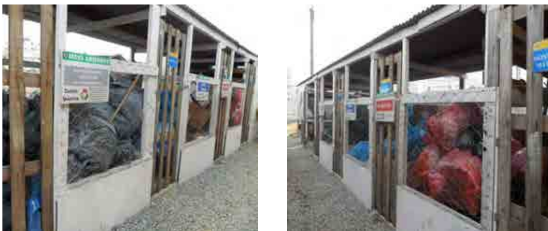
Figura 56 – Locais para acondicionamento temporário dos resíduos provenientes da construção do empreendimento, localizados na parte lateral do canteiro de obras.
