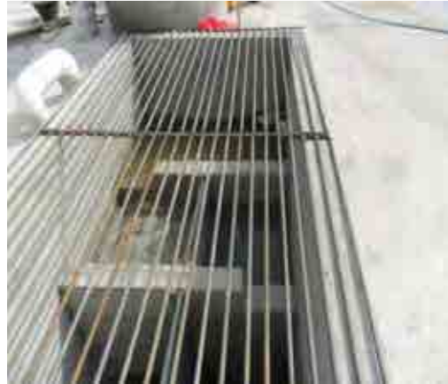
Figura 40 – Caixa de decantação localizado ao lado da pista de acesso de veículos da obra.
