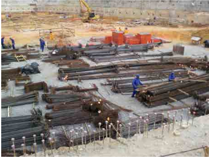
Figura 42 – Armazenamento preventivo do aço no canteiro de obras, conforme estabelecido pelos procedimentos de certificação LEED Gold.
