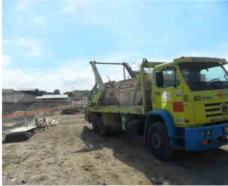
Figura 57 – Transporte dos resíduos de madeira e aço oriundos da execução do empreendimento.
