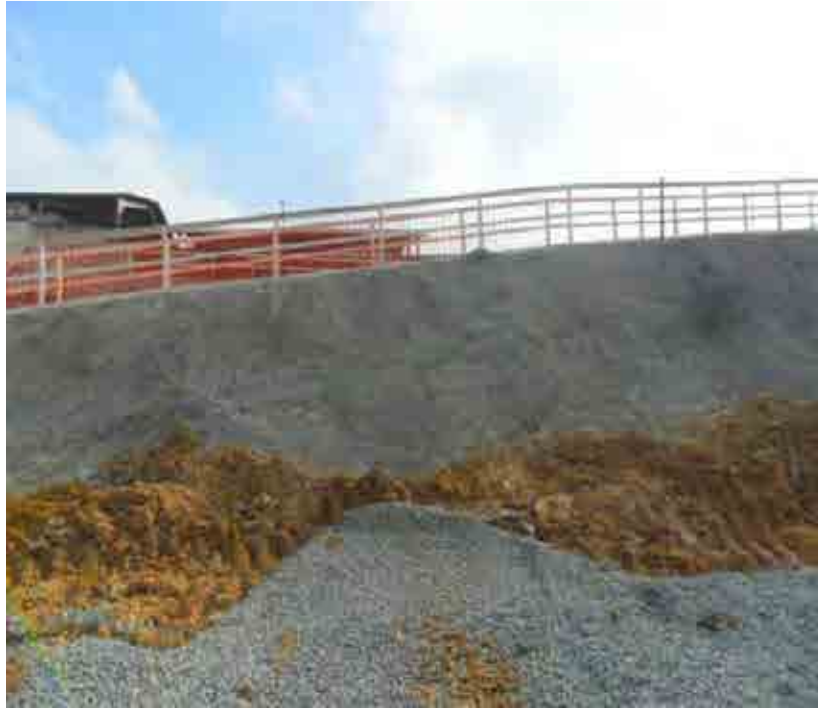
Figura 35 – Sobra do concreto utilizado nos taludes da obra para minimizar os riscos de erosão.
