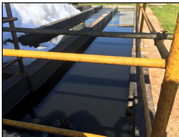
Figura 4.9. Ponto de coleta do efluente tratado (P4) da Estação de tratamento de Esgoto de Candeia.
