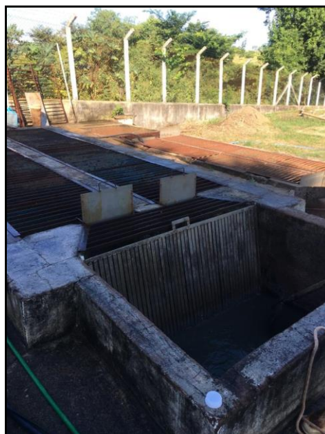
Figura 4.13. Ponto de coleta do esgoto bruto (P8) da Estação de tratamento de Esgoto de Tibiriçá.
