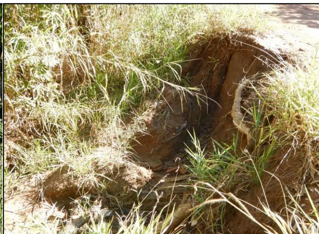
Foto 27. Talude apresentando erosão intensa.
