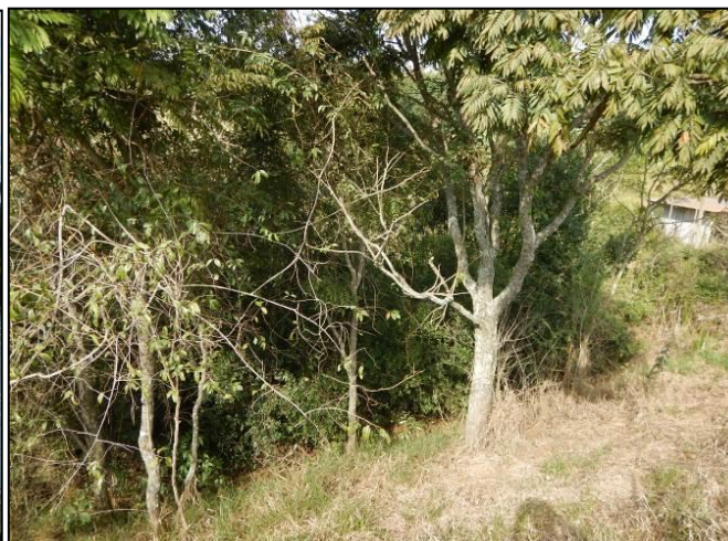
Foto 44. Talude a jusante com vegetação de grande porte.
