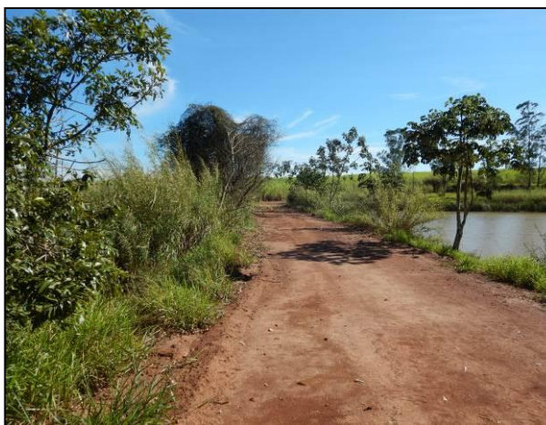
Foto 24. Maciço com falta de manutenção e apresentando vegetação arbórea em seu eixo.
