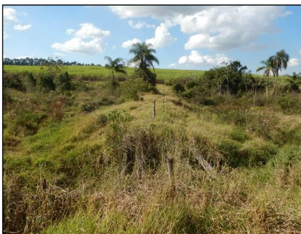
Foto 47. Evidências de rompimento de barragem.
