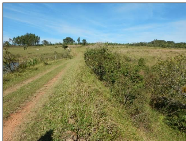
Foto 7. Talute com alta inclinação à jusante do reservatório.
