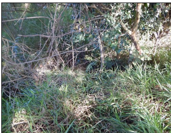
Foto 28. Vertedouro a jusante totalmente assoreado.
