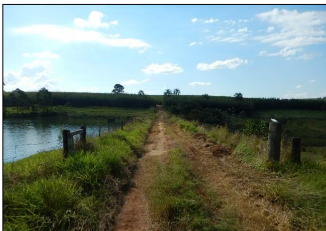
Foto 39. Vista do maciço em bom estado e com falta de manutenção.
