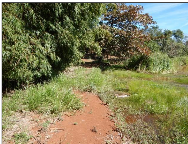
Foto 18. Maciço apresentando falta de manutenção e presença de vegetação.
