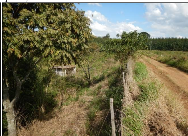
Foto 42. Talude a jusante apresentando intenso assoreamento.
