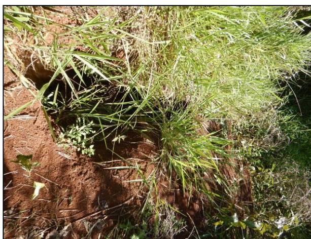
20. Vertedouro mal dimensionado com sinais de assoreamento intenso.
