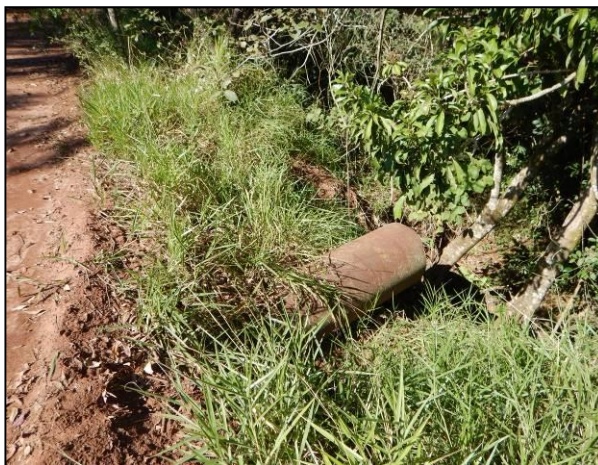
Foto 26. Tubo de emergência presente na parte a jusante do reservatório.
