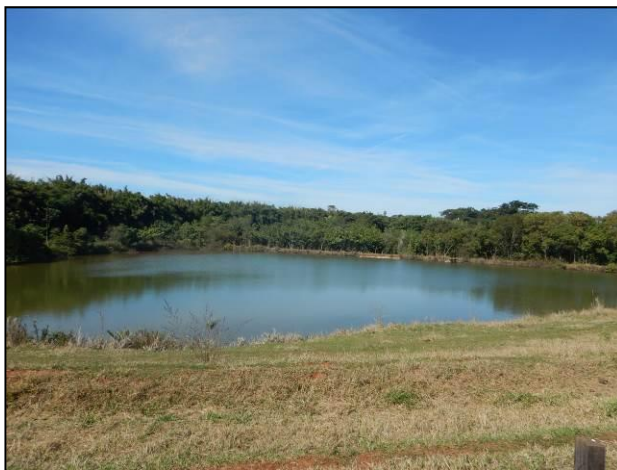
Foto 10. Abundância de vegetação arbórea no talude a jusante.
