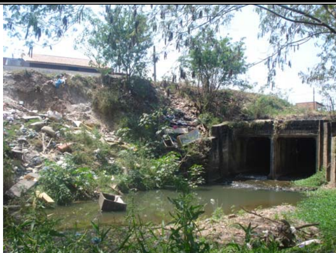
5 – Deposito de lixo irregular na APP e canalização
