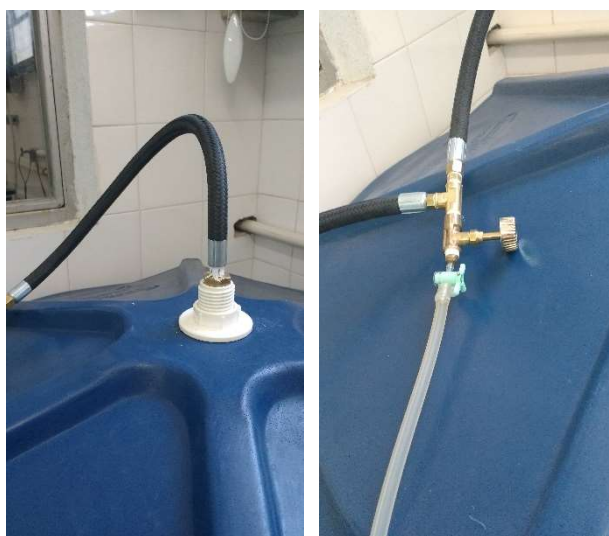
Figura 13 - Detalhe da ligação à tampa da caixa d'água do sistema de coleta de biogás (à esquerda) e saída adaptada para coleta de biogás antes de passar pelo filtro de carvão ativado (à direita)
