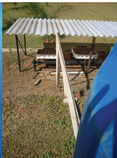
Figura 14 - Detalhe tubo de PVC
