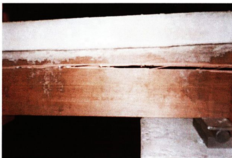
Figura 12 – Detalhe do cisalhamento na madeira
