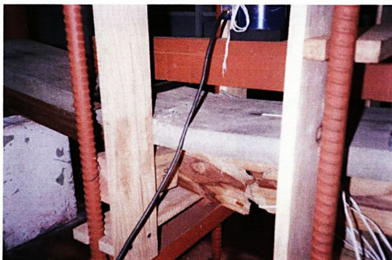
Figura 07 – Ruptura da viga mista 1 de pinus e concreto
