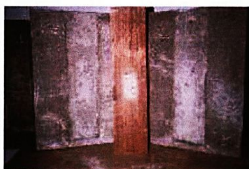
b) concreto alterado perto dos parafusos e grande esmagamento na madeira
