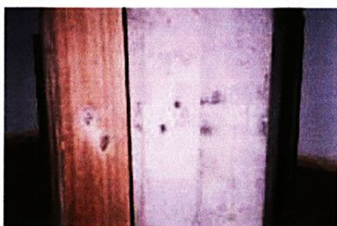
a) concreto intacto e grande esmagamento na madeira
