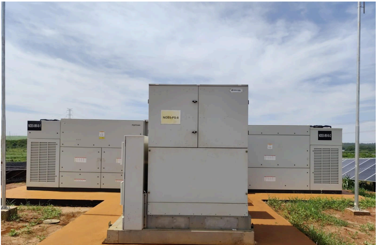
Figura 3 - Bloco de condicionamento de um SFV.
