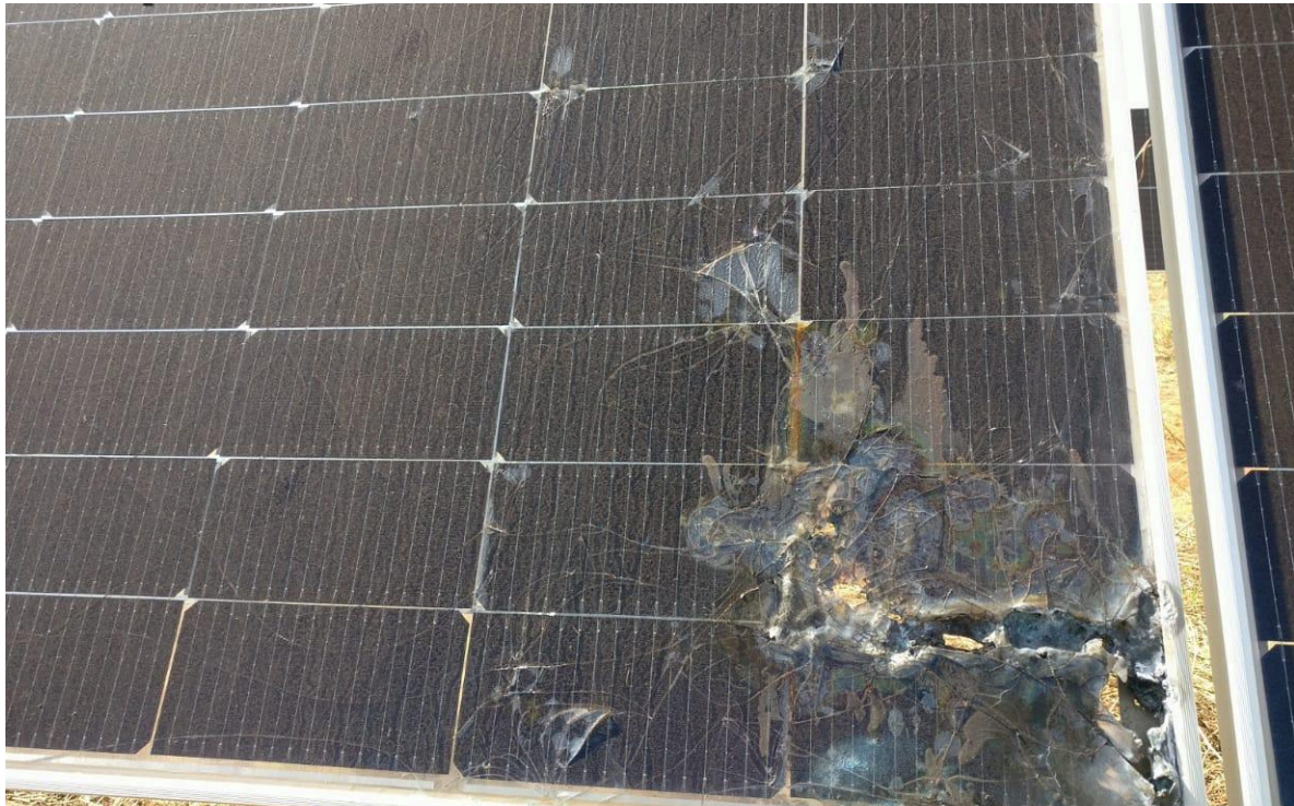
Figura 8 - Dano em módulo causado por hotspot .
