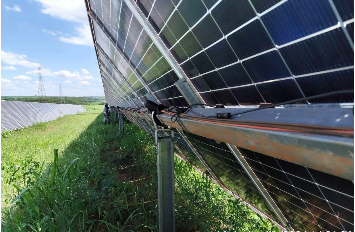
Figura 2 - Bloco gerador de um SFV.
