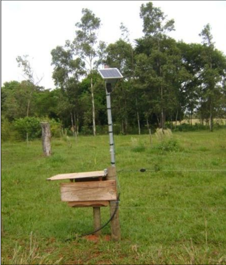
Figura 20 – Sistema de captação de energia solar para fornecimento à cerca elétrica
