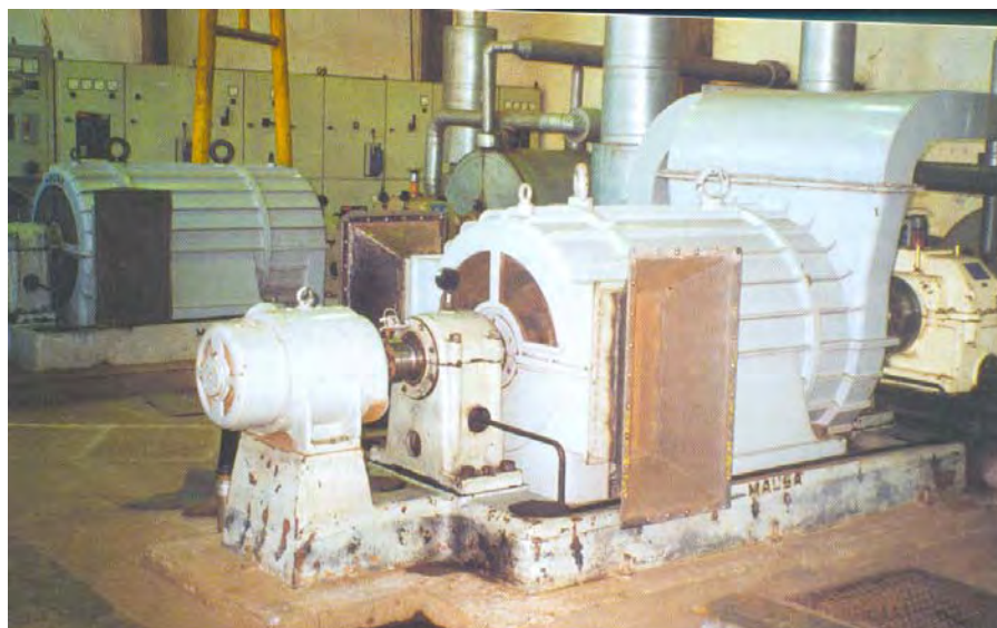
Figura 30 – Geradores 1500 kVA, 380 V
