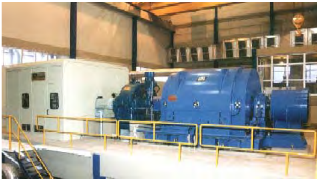
Figura 31 – Gerador 31.250 kVA, 13.800 V, 4 polos, instalado em uma usina de açúcar e álcool em 2002.
