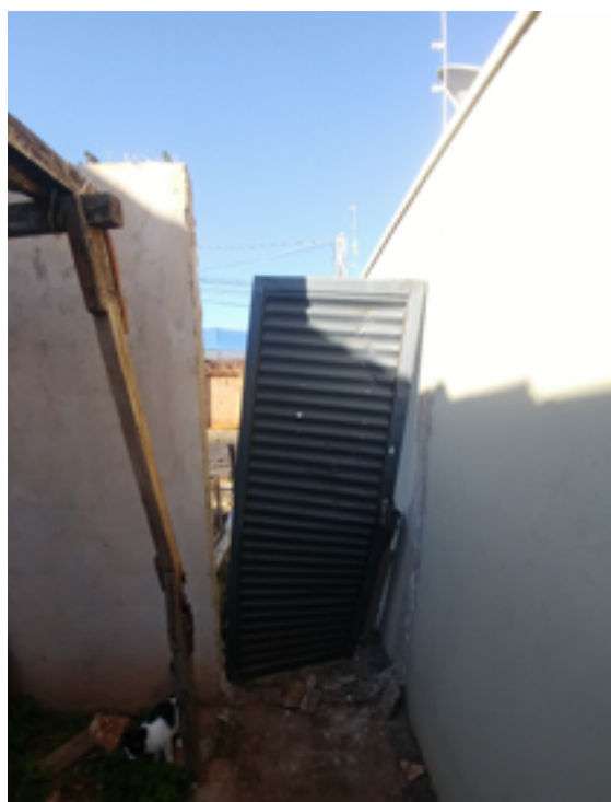
IMAGEM 37: Portão da Casassa destruído, 2019.
