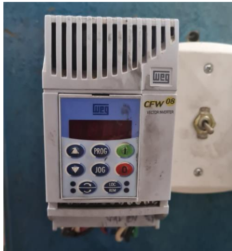
Figura 29 – Inversor de frequência WEG CFW 08 instalado.
