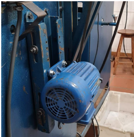
Figura 14 – Motor elétrico fixado na parede do fundidor de tiras.
