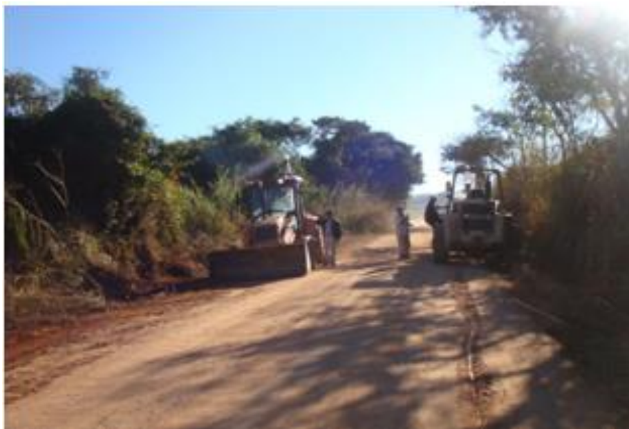
Figura 42 – Estradas em recuperação no bairro Sítio Novo em julho de 2015
