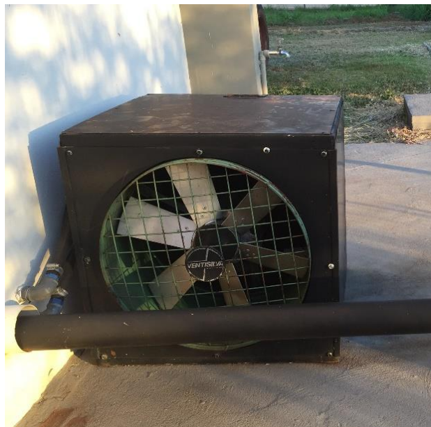
Figura 12 - Torre de resfriamento do dinamômetro.
