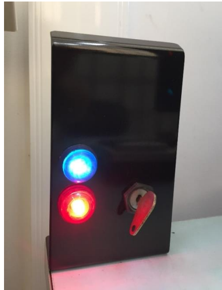
Figura 22 - Painel de monitoramento do motor.
