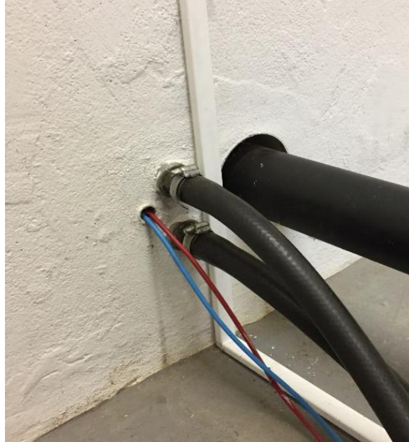
Figura 13 - Conexões da torre de resfriamento com a sala de teste.
