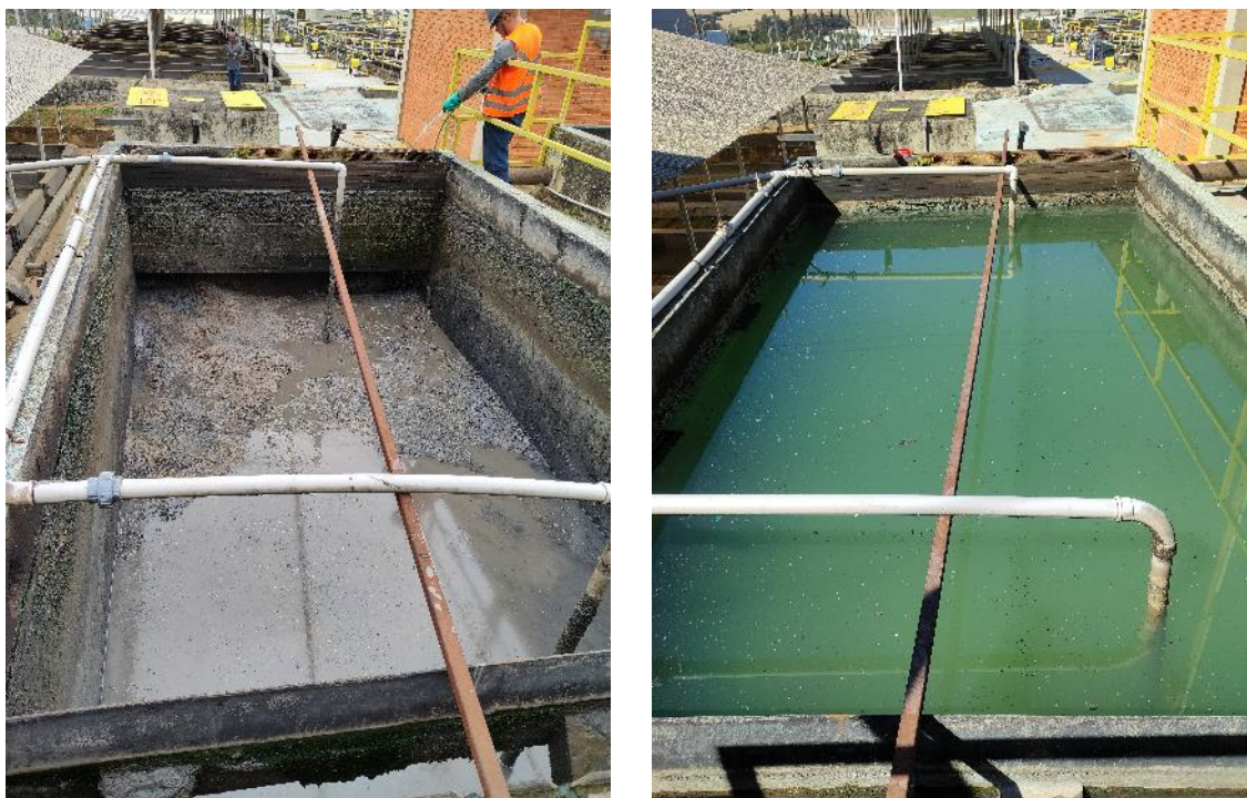
Figuras 9 e 10- Tanque de decantação pré bomba de recirculação/ Tanque de decantação pós instalação da bomba
