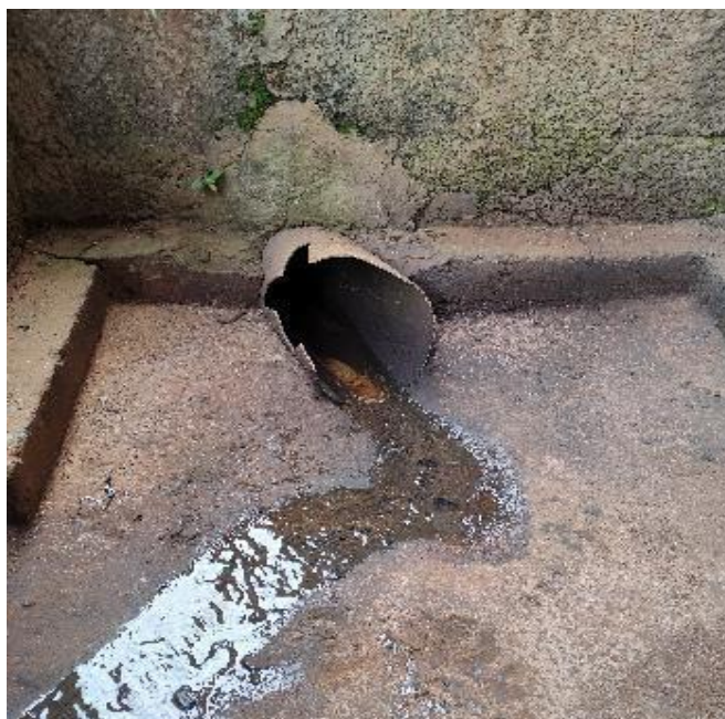
Figura 12- Tubulação conectada ao tratamento industrial.
