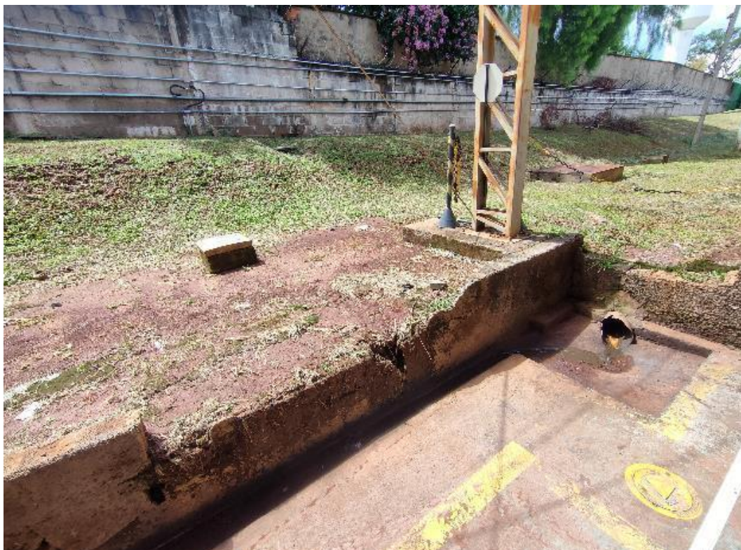
Figura 11- Situação da mureta do pátio de resíduos pré reforma.
