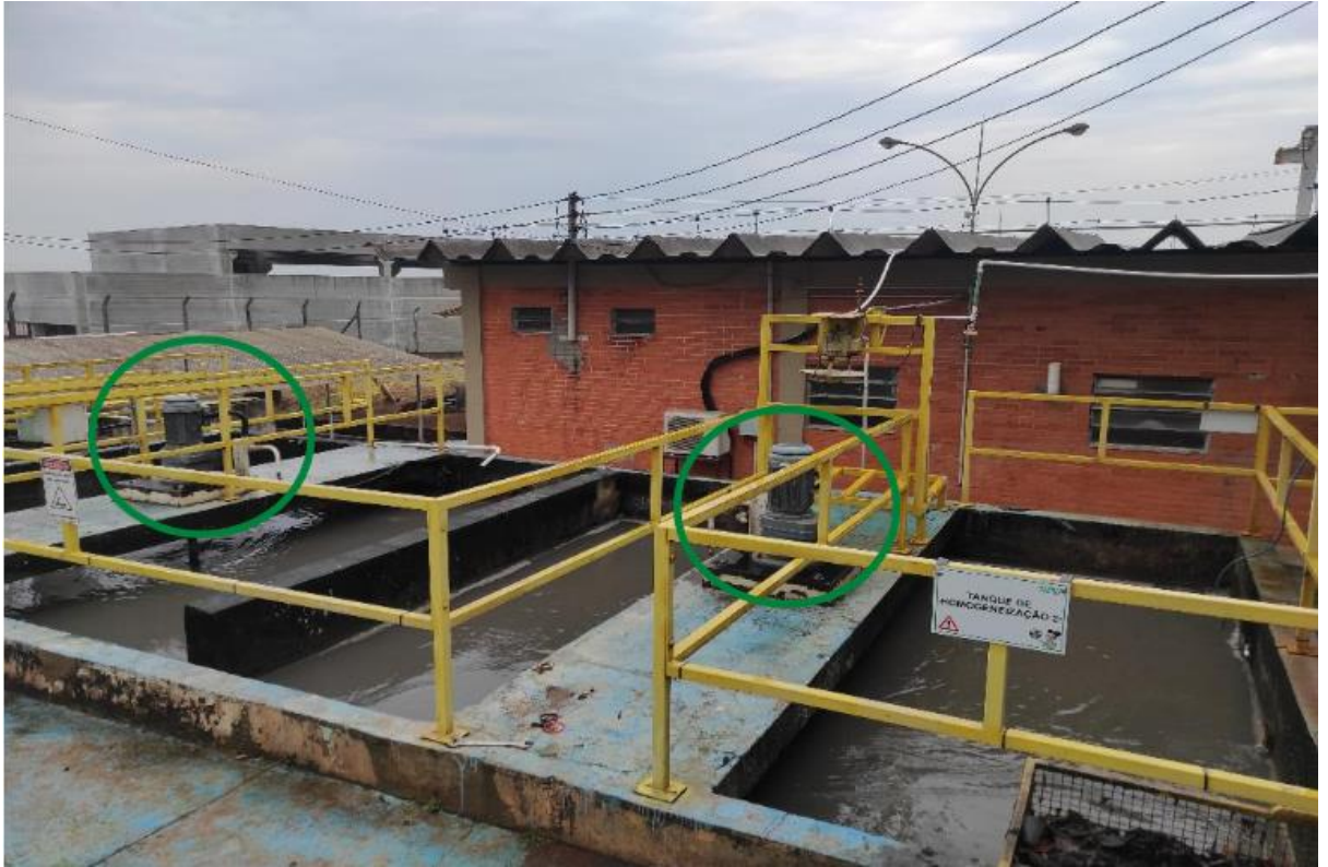
Figura 4- Tanques de homogeneização do tratamento industrial.
