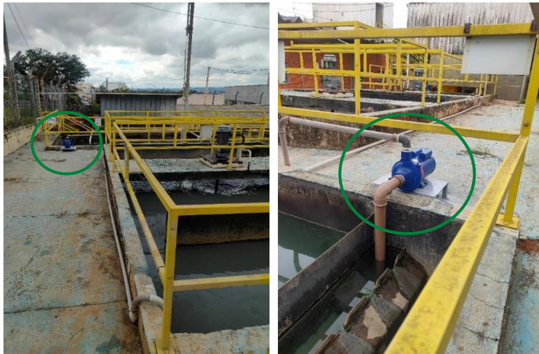
Figuras 7 e 8- Bomba de retorno de efluente instalada
