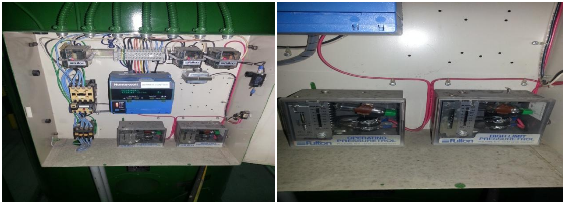
FIGURA 13 – Esquema interno do painel da caldeira do laboratório em destaque os dois pressostatos.
