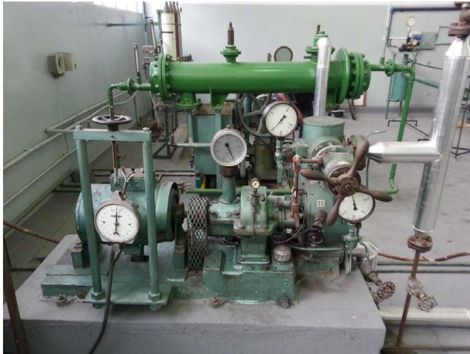
FIGURA 8 – Turbina a vapor C/D 3000 Greenbat, e ao fundo Trocador de Calor (casco tubo – cor verde) do laboratório FEG-UNESP.
