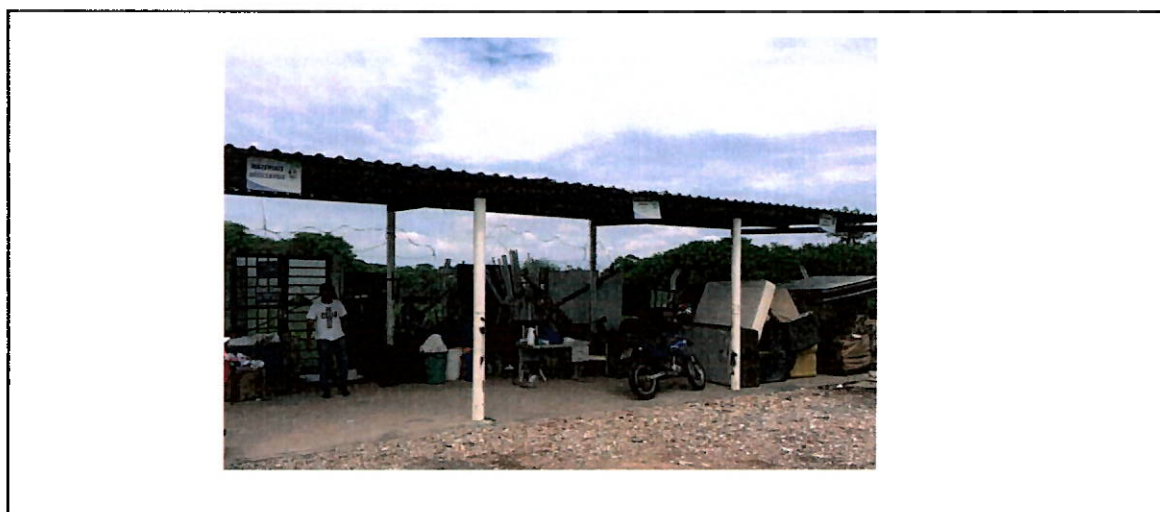
Quadro 18: Abertura/quebra no alambrado de cercamento;
